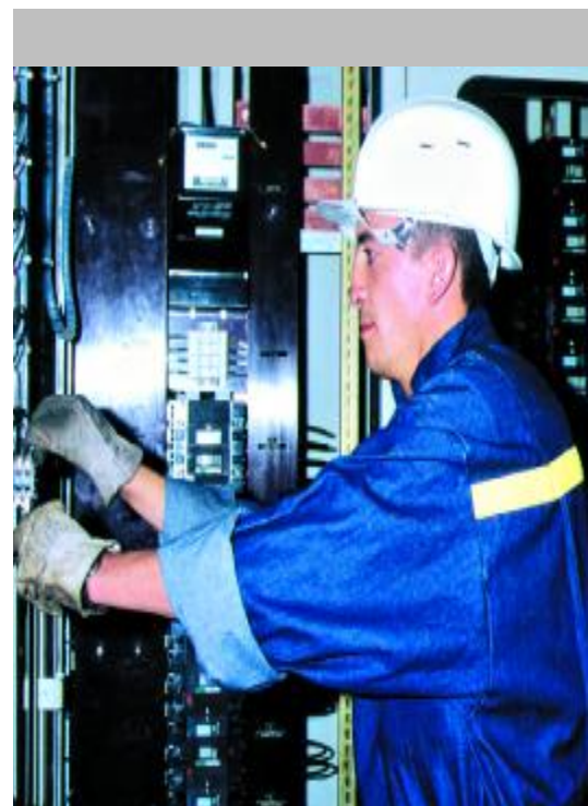
Poste de distribution MT/BT
