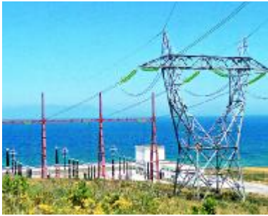
Station terminale de Ferdioua de l'interconnexion Maroc-Espagne
