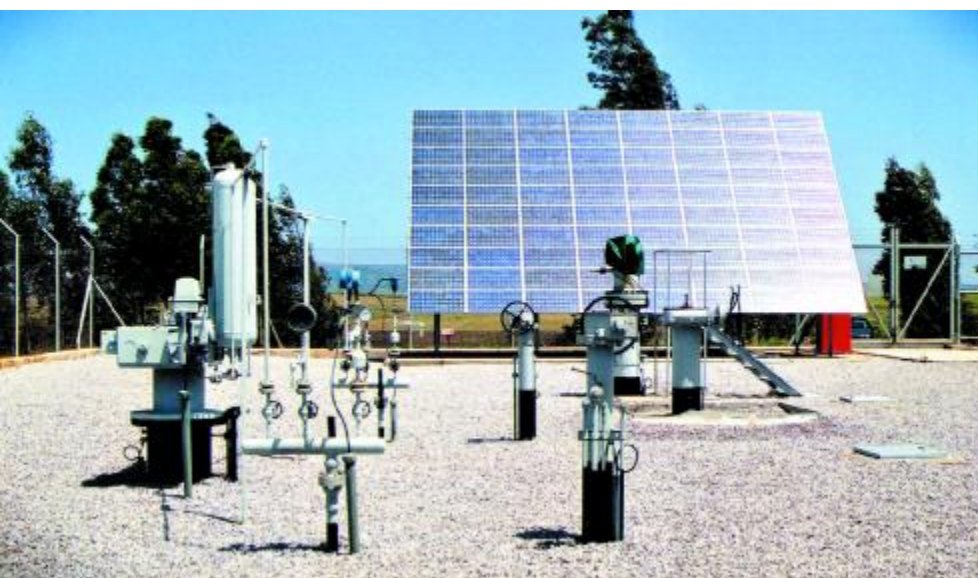
Point de raccordement de la bretelle du gazoduc
