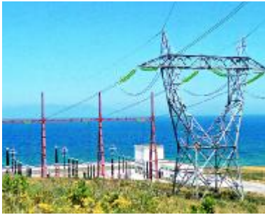
Station terminale de Ferdioua de l'interconnexion Maroc-Espagne
