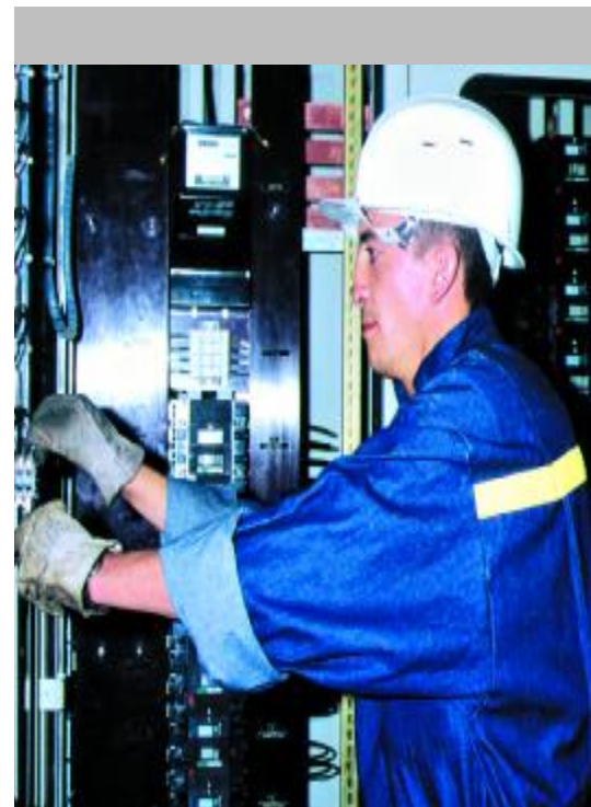
Poste de distribution MT/BT
